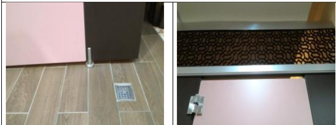
圖四 廁間門板下緣離地面離為 2 公分範圍內，門板上緣離地面應為 210 公分，並考量上緣到天花間之通風及隱密性。(來源：內政部建築研究所，2015)
