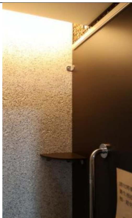
圖六 廁間內設置照明自動感光點減裝置，以節省電源及如廁安全感。(來源：內政部建築研究所，2015)
